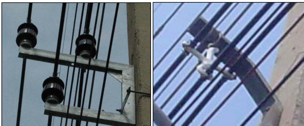
รูปที่ 8 การติดตั้งลูกถ้วย Pin Post (ซ้าย) แทน Spacer ในตำแหน่งที่ใช้งานอยู่เดิม (ขวา)
